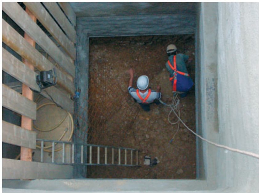
Sanierung Tagesbruch an der S 258 (Foto: Sächsisches Oberbergamt)
