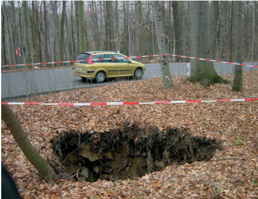
Tagesbruch an der S 236 bei Augustusburg (Foto: Sächsisches Oberbergamt)
