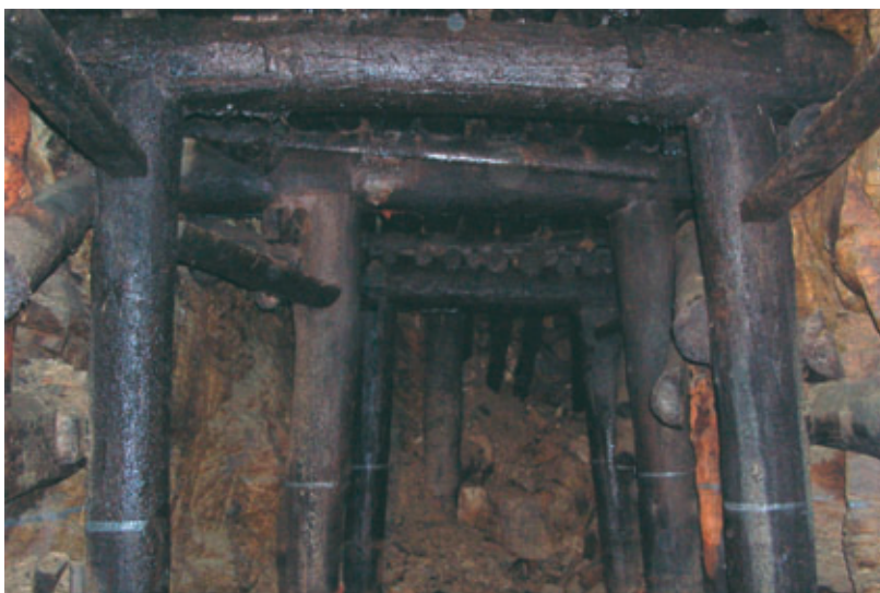
Verbruch „Tiefer Erbstolln“ Scheibenberg (Foto: Sächsisches Oberbergamt)
