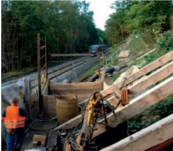
Tagesbruch Hans-Hesse-Straße in Annaberg-Buchholz (Foto: Sächsisches Oberbergamt)
