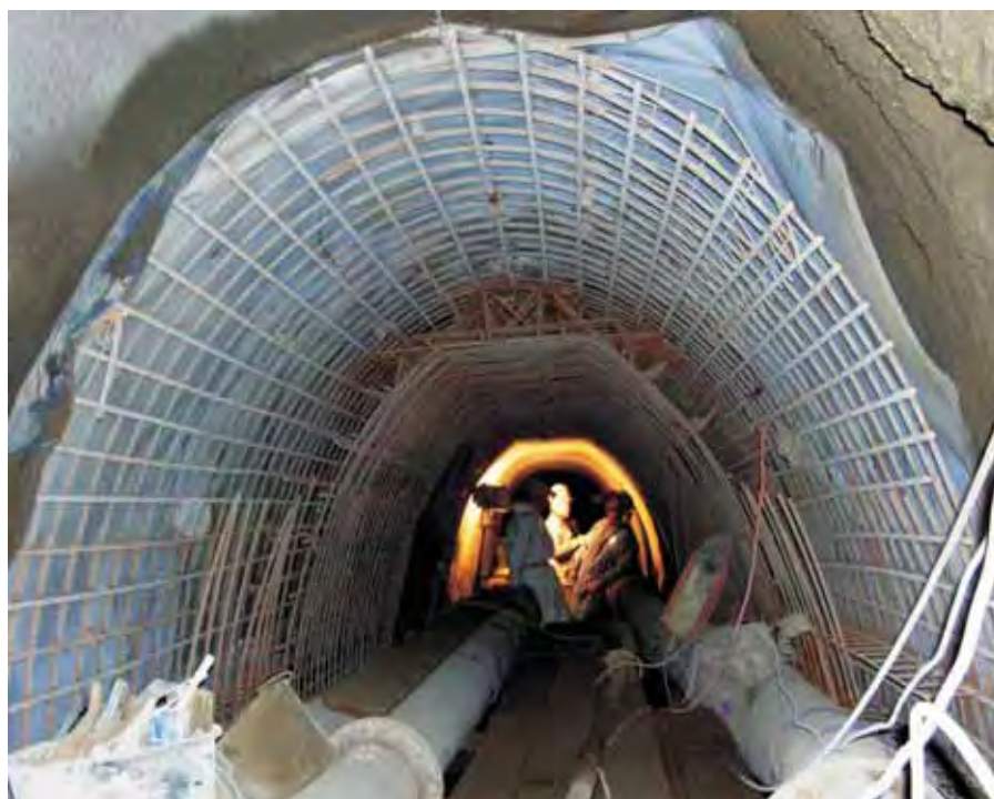
unten: Sicherungsarbeiten im Schluchtengewölbe des Rothschönberger Stolln, Nähe 1. Lichtloch (Foto: BST Freiberg GmbH & Co. KG)
